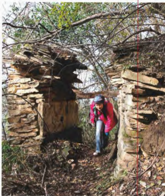
状元岩外的一道石头“拱门”已经坍塌，仅靠一根腐朽的木头勉强支撑
